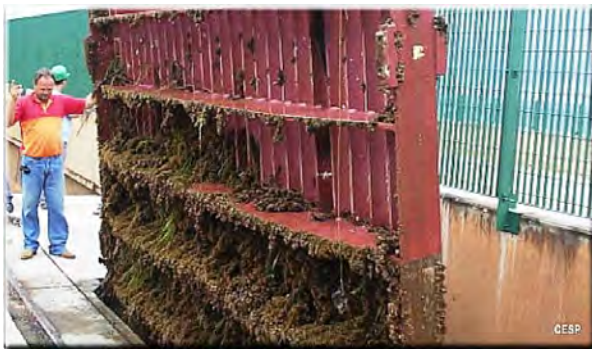
Infestação de mexilhões em grade de hidrelétrica
